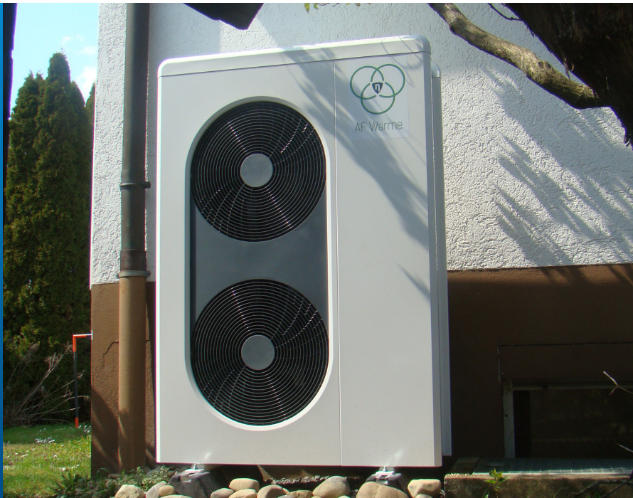
Außeneinheit einer Wärmepumpe
