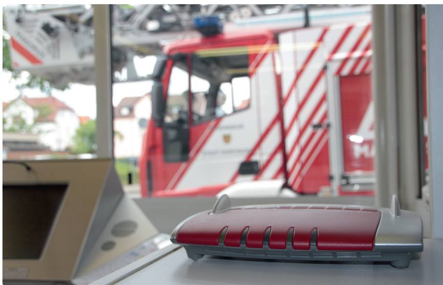
De FRITZ!Boxen zorgen voor stabiele internetverbindingen op alle zeven locaties van de brandweer Nürtingen.
